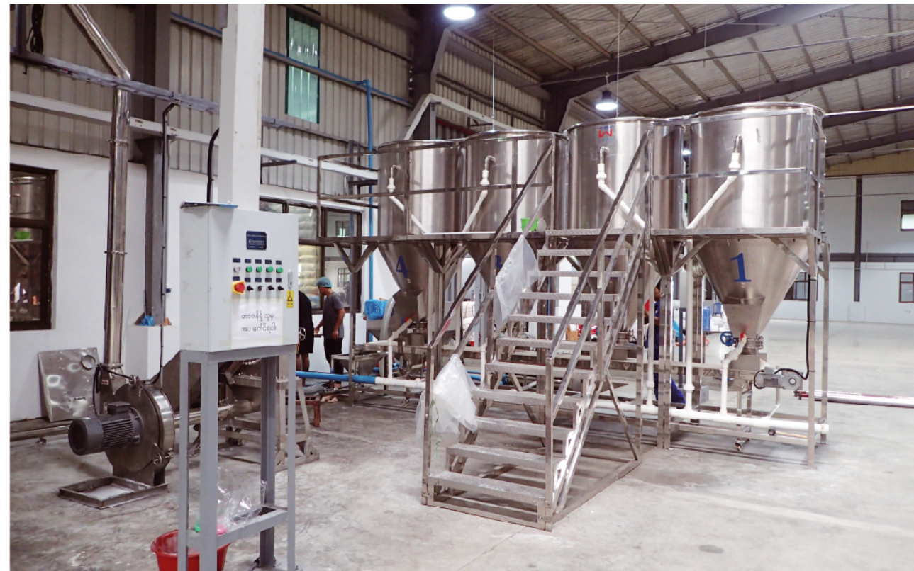
Rice Water Absorption System 大米吸水系统
